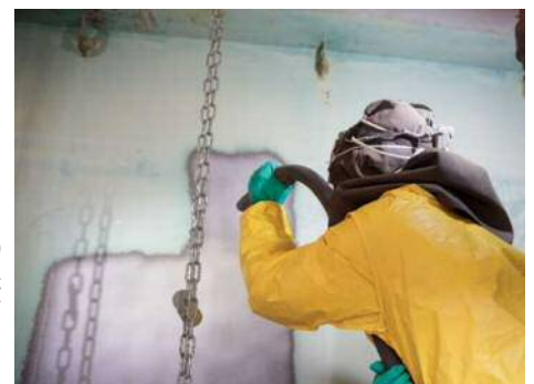
循環式ブラスト工法の施工状況 → 粉じんが少なく、視界が良好
