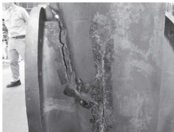
写真3 バルブの亀裂状況 (拡大)
