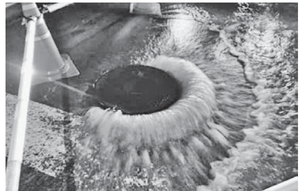
写真1 漏水発生当初の状況
