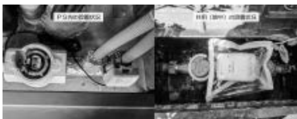
写真1 スマートメーター設置状況 (A街区)
