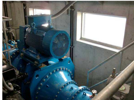
写真1 小水力発電設備（横浜市川井浄水場）
