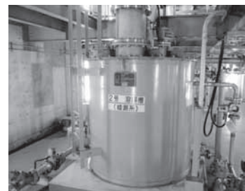
図2 混合槽（溶解槽）概観
