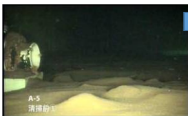
清掃前: 底版に溜まり積もった沈澱物
