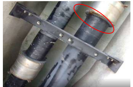
図3 伸縮管カバーの錆
