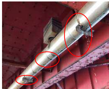
図2 管体からの漏水
