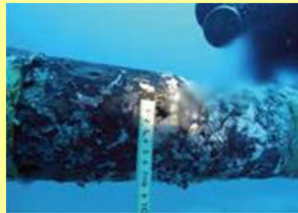
既設管の孔食事例
