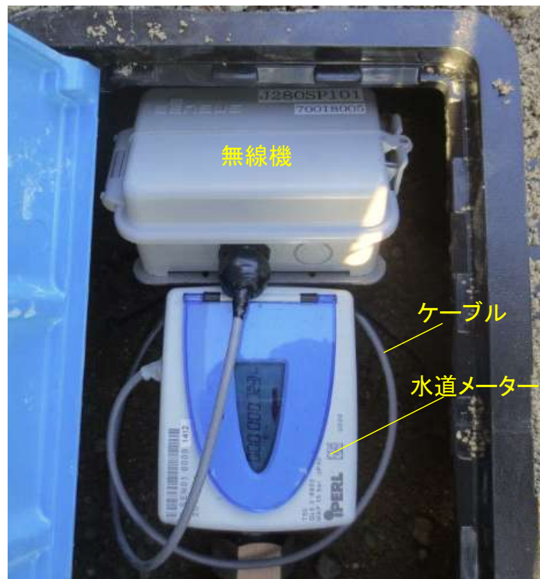
<固定端末(水道メーター)>
