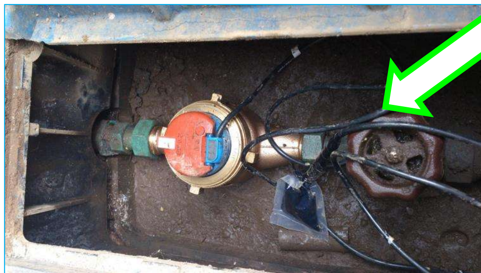
水道メータBOX （戸建て住宅）
