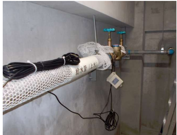
機械室設置サイト
