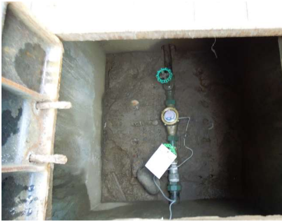
鉄蓋、地下設置サイト
