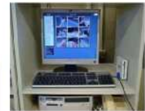
監視端末設置状況
