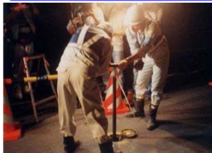
手動弁操作による給水制限
