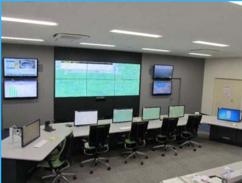
中央コントロール室(中央監視制御装置)
