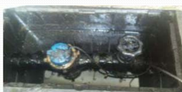
雨水等で水没した水道メータます
