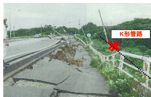
写真 1 盛土傾斜部の状況 (A 地点)
