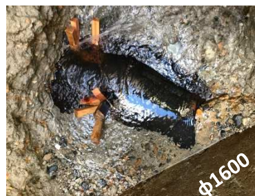
ドレン管漏水状況
