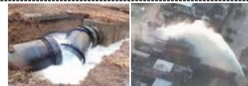
東日本大震災における継手離脱
