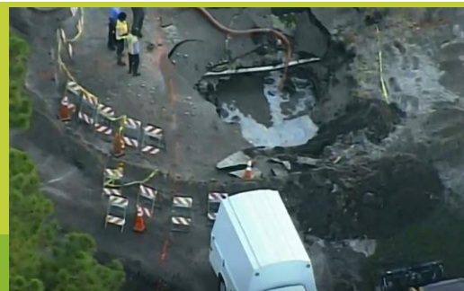
管路被害状況
