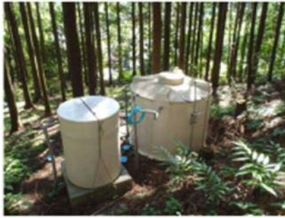
(左) 緩速ろ過型簡易ろ過装置 (右) 配水タンク
