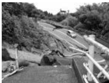
写真1 道路崩壊により送水管機能が停止
