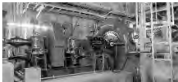
写真2 平岸配水池水力発電 水車
