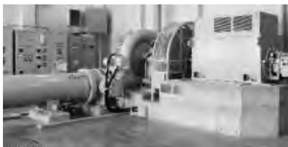
写真1 藻岩浄水場水力発電 水車
