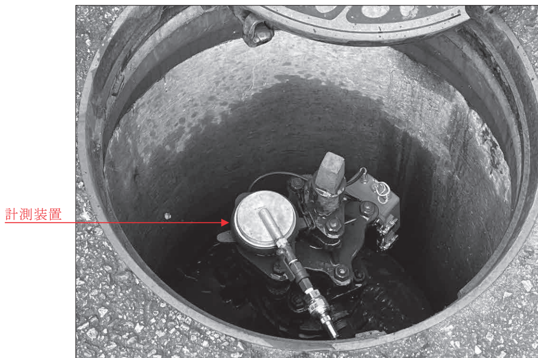
図 2.5.3.3 計測装置の設置状況【A市A地区】
